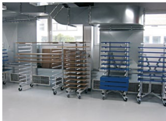
Abb. 2 Hordenwagen im Abdunst- und Trocknungsraum
