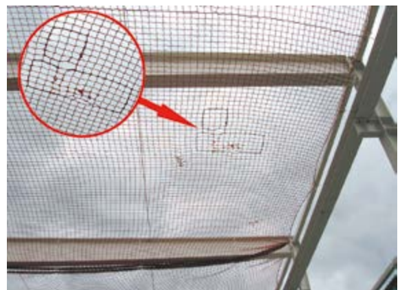
Abb. 4-14 Beschädigte Maschen; Reparatur des Netzes ist so nicht zulässig
