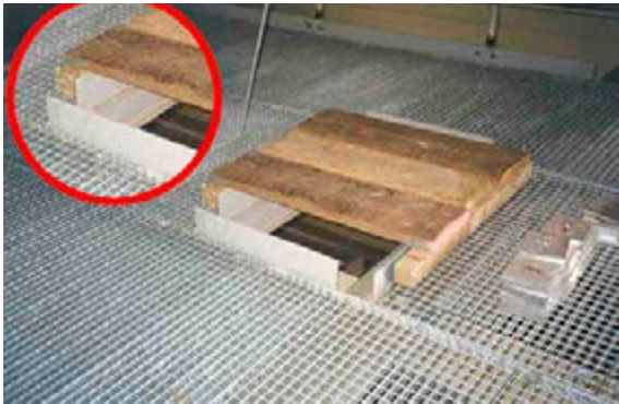
Abb. 4-15 Nicht vollständig geschlossene Bühnenöffnung
