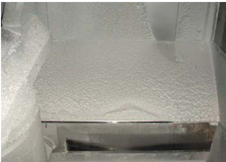
Bild 48 Verklebungen im Maschineninnenraum
