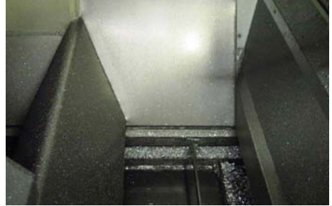
Bild 24 großflächige Öffnungen in den Späneförderer
