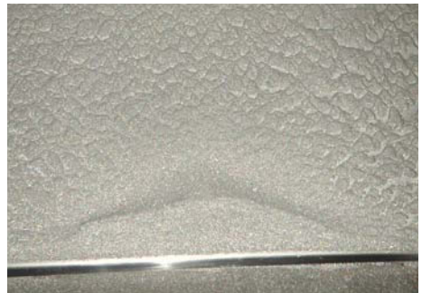
Bild 49 Anbackungen auf den Blechen
