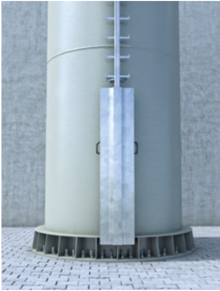
Abb. 14 Steigleiter bis zum Boden geführt und gegen unbefugte Benutzung gesichert
