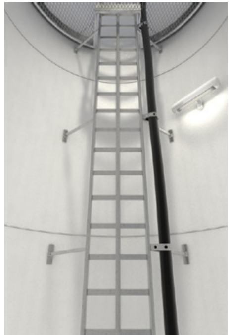
Abb. 20 Steigleiter in einer Windenergieanlage
