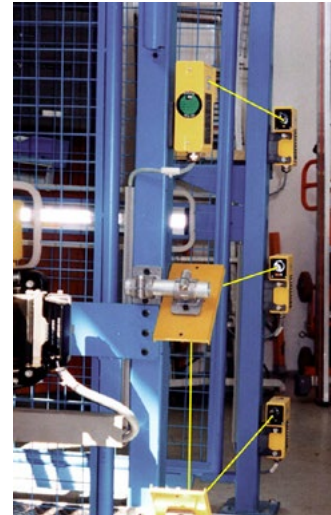
Abb. 3-7 Lichtschranke als Beispiel für eine Schutzmaßnahme Rang 2
