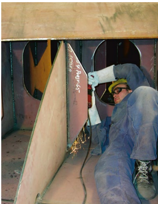
Abb. 9-1 Enger Raum mit erhöhter elektrischer Gefährdung
