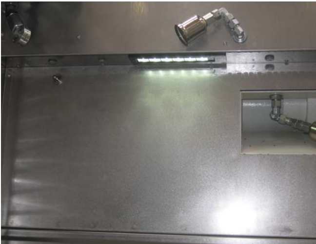
Abb. 11 Löschdüse und Wärmemelder/Temperatursensor im Maschineninnenraum
