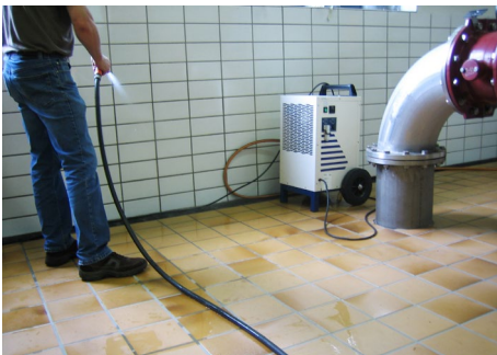
Abb. 11 Strahlwassereinwirkung auf Anschlussleitung und Betriebsmittel
