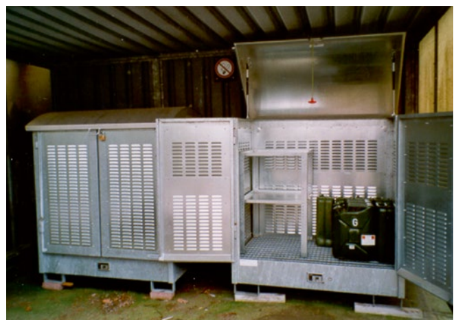
Abb. 4 Lager für Kraftstoffbehälter im Freien
