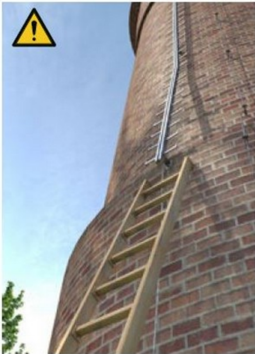
Abb. 4 Unsichere Zugangssituation bei Steigleitern am Schornstein
