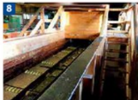
Fördereinrichtung mit sicherem Übergang
