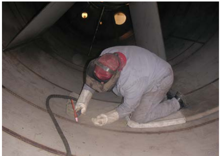
Abb. 5-4 Geschützt durch isolierende Unterlage
