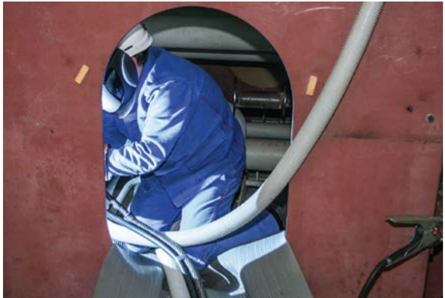
Abb. 5-1 Beispiel für erhöhte elektrische Gefährdung beim Schweißen
