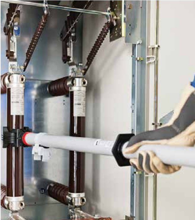
Bild 5-9: Wechsel einer HH-Sicherung mit vorschriftsmäßiger Sicherungszange
