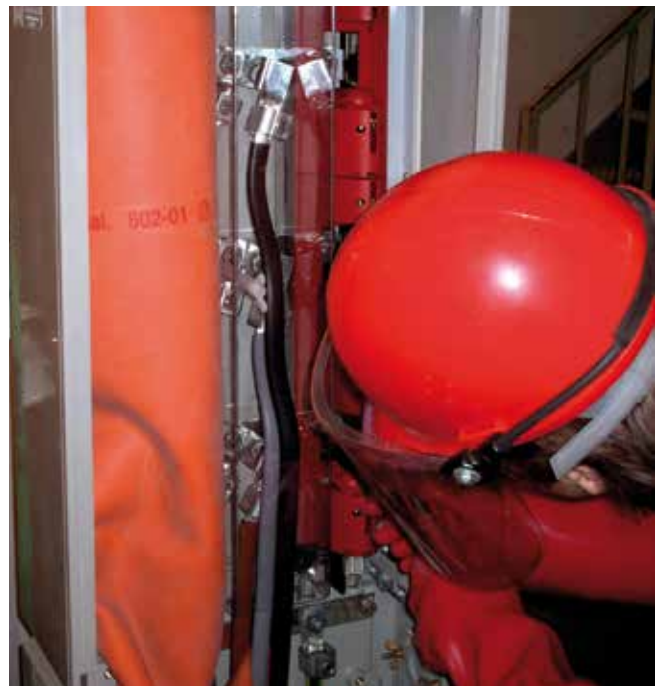
Bild 5-20: Anbringen einer Abdeckung auf unter Spannung stehenden Teilen
