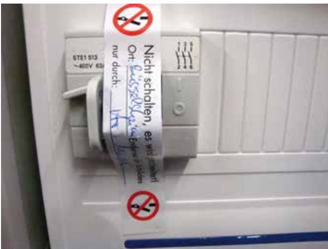
Bild 5-11: Gegen Wiedereinschalten gesicherter Hauptschalter
