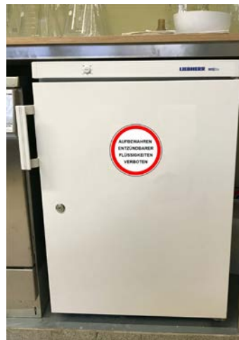
Abb. 21 und 21a Kühlschränke, die nicht für die Aufbewahrung entzündbarer Flüssigkeiten geeignet sind, sind mit einem Aufkleber zu kennzeichnen
