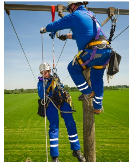
Abb. 10.c Nachdem das Rettungssystem befestigt ist, wird die persönliche Schutzausrüstung gegen Absturz der zu rettenden Person mit dem Rettungssystem verbunden. Nun wird die ursprüngliche Verbindung der zu rettenden Person mit dem Holzmast gelöst und der Abseilvorgang kann beginnen.
