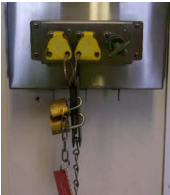
Abb. 40 Beispielhafte Lockout/Tagout-Maßnahme: Mit Vorhängeschlössern gesicherte Staubkappen (gelb) einer Schlüsselwechselstation verhindern das Einstecken der Schlüssel. Schließbügel ermöglichen das Anbringen mehrerer Vorhängeschlösser (vergl. Abb. 41).
