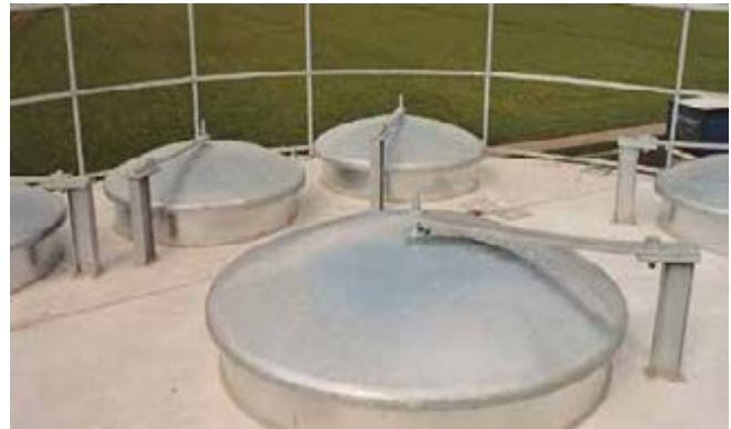
Abb. 9.9 Explosionsklappen im Deckenbereich eines Silos
