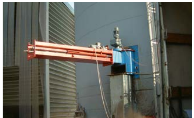
Abb. 7.11 Notentleerung eines Silos über transportable Austragschnecke in einen Container
