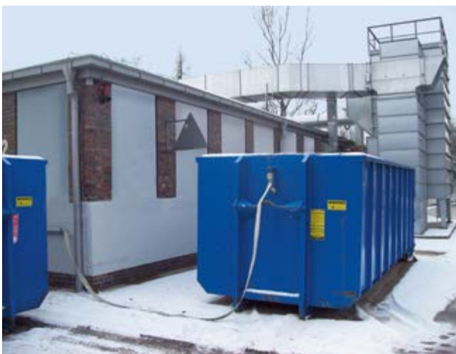
Abb. 9.1 Späne-Container mit Löscheinrichtung und Druckentlastung (Druckentlastung im Deckelbereich nicht sichtbar)
