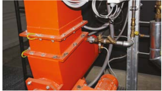
Abb. 6.23 Fallschacht von einer Siloaustragung zur Stoker-Schnecke
