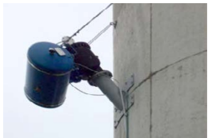
Abb. 8.2 Beispiel für eine am Silokörper montierte Druckluftkanone
