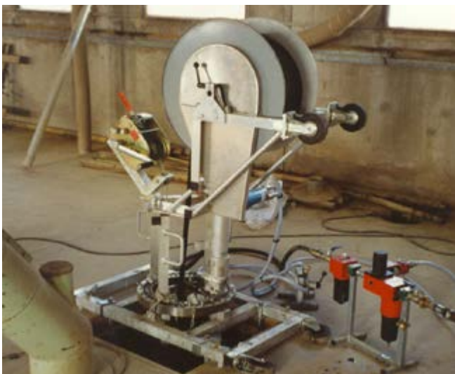
Abb. 8.5 Bedieneinrichtung, Energiezufuhr und Steuerung außerhalb des Späne-Lagerraumes
