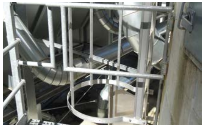
Abb. 5.10 und 5.11 Steigleiter nach ASR 1.8, Nr. 4.6
