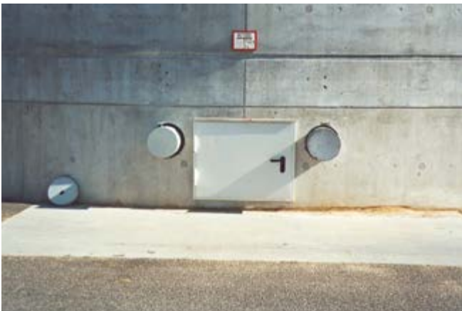
Abb. 7.8 Außerhalb des Silokörpers gelegene Anschlussstutzen für eine Transportanlage mit Umschaltweiche für die Austrageinrichtung (befindet sich hinter der verschlossenen Tür)
