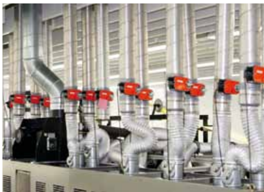
Absaugung über fest installierte Abluftleitungen
