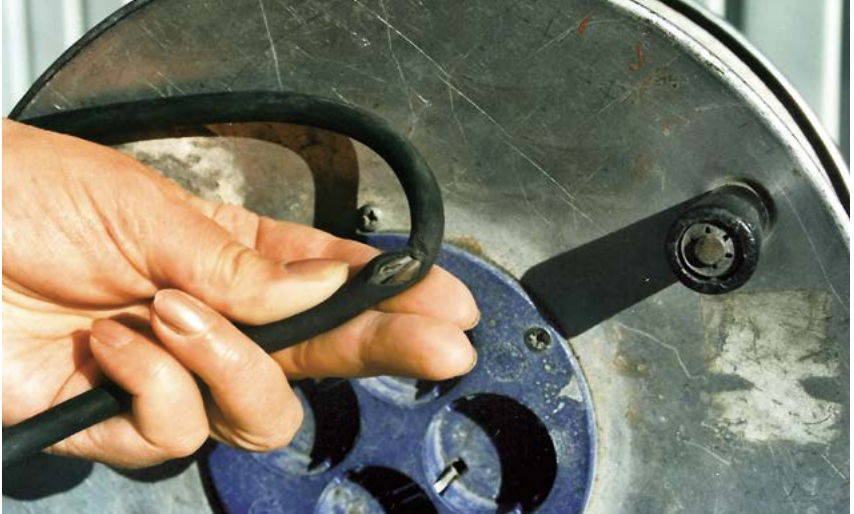
Abb. 3.4 Beschädigte und für den Bereich Bau- und Montagestellen ungeeignete leichte Gummischlauchleitung Typ H05RR-F; außerdem weisen die Steckdosen nicht die notwendige Schutzart IP X4 auf.
