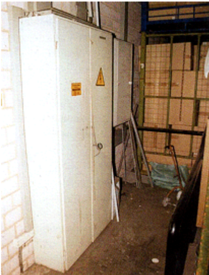
Bild 6-2: Elektrische Verteiler und Schaltanlagen
