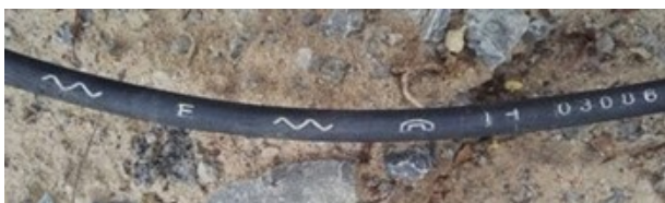
Abb. 2 Glasfaser-Telekommunikationsleitung mit "Wellenlinie"
