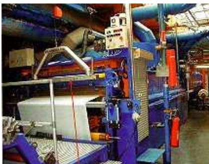
Abbildung 28: Streichanlage mit lokaler Absaugung
