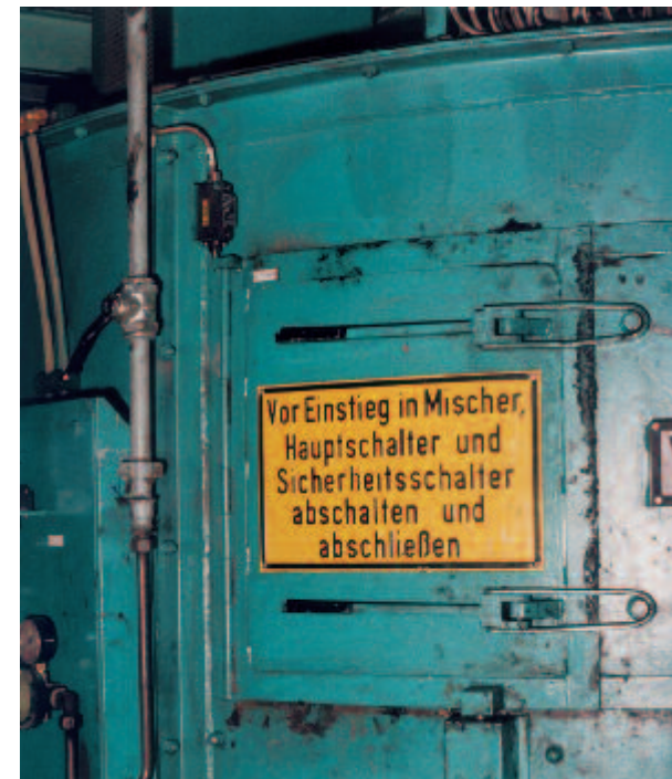
Bild 3-4: Formsandmischer mit gesicherter Zustiegsöffnung
